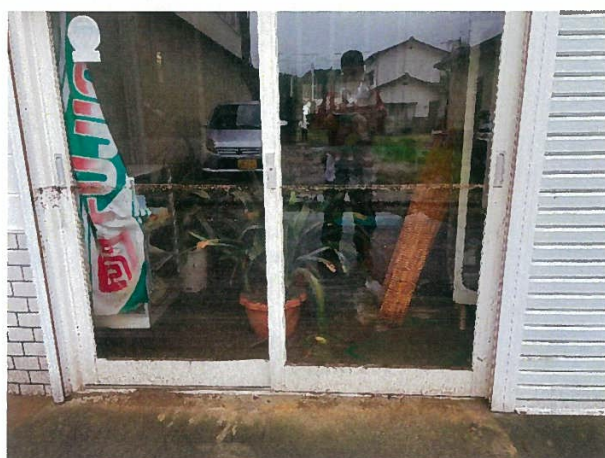
こちらのお宅は50センチあまり浸水
